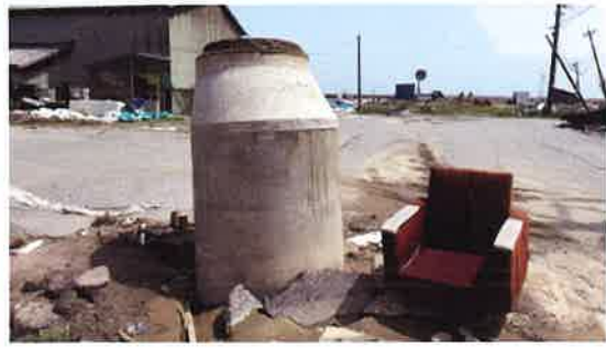
地震の影響で隆起したマンホール
